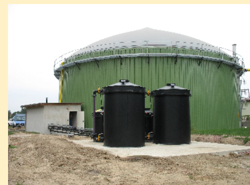
BEKOM-Anlage 170 m 3 /h Rohgas
