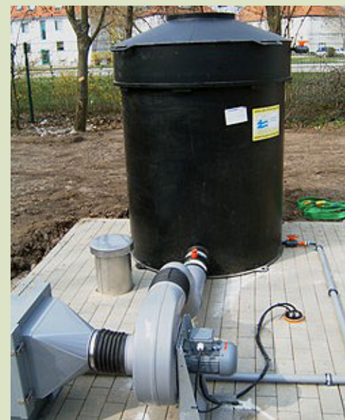
BEGA-System für Abluft aus Pumpwerk
